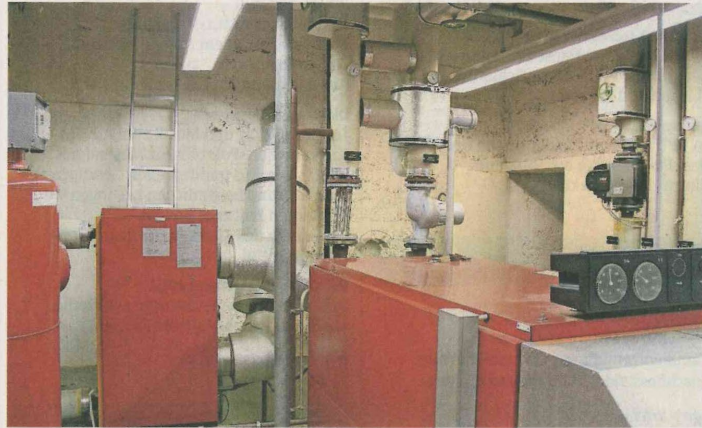
Soll ersetzt werden: Die alte Öl-/Gasheizung unter der Kirche.
